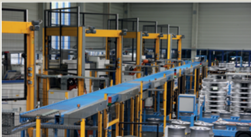
Abb. 1: Schutzeinrichtungen mit Hubtoren an den Glanzdrehzellen
