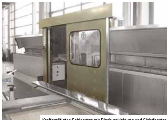
Kraftbetätigtes Schiebetor mit Blechverkleidung und Sichtfenster
