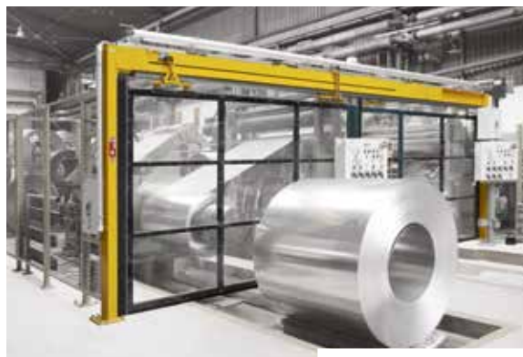
Ausgabestation einer Bandanlage
