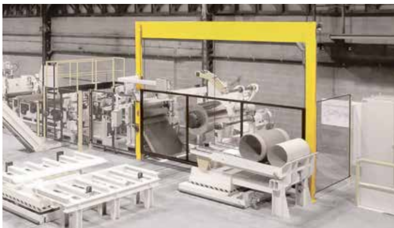
Im Anwendungsfall einer Bandanlage
