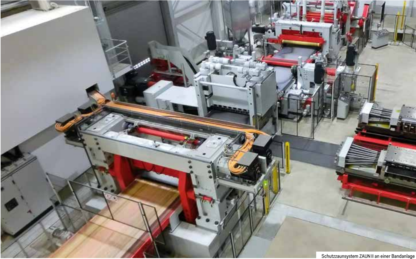
Schutzzaunsystem ZAUN II an einer Bandanlage
