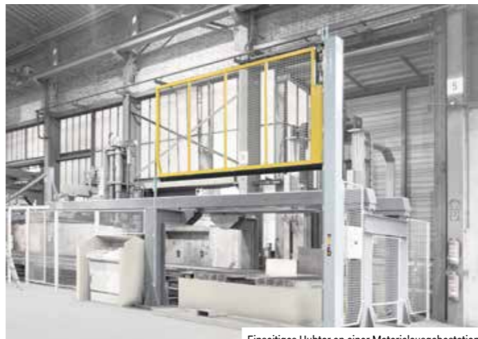
Einseitiges Hubtor an einer Materialausgabestation
